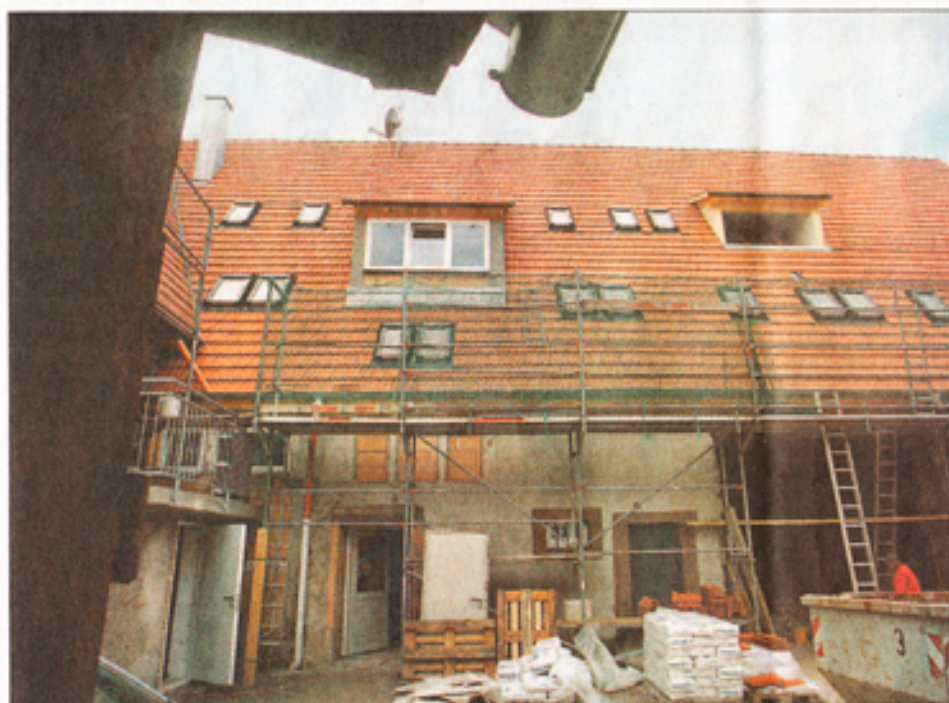
Der Außenputz ist noch nicht fertig, innen gibt es aber einiges zu sehen. Foto: factum/Wolschendorf
